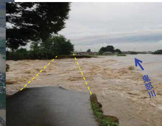
被災状況(拡大写真)
