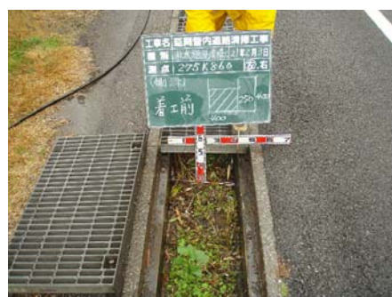
【側溝の土砂堆積状況】
