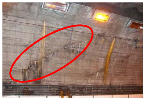
【トンネル損傷（ひび割れ）】
