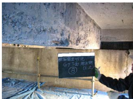
【補修前（コンクリート劣化・剥落）】
