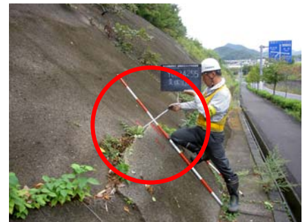
【法面の異状発見】
