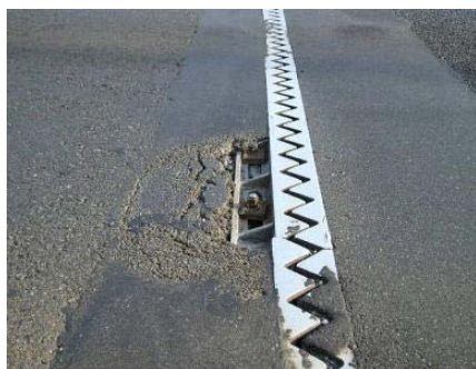
【補修前（橋の伸縮装置の破損）】
