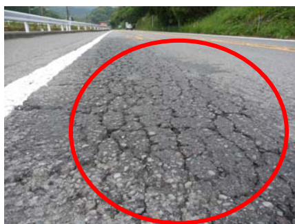
【ひび割れ状況】
