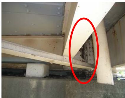
【橋梁損傷（腐食、断面欠損）】
