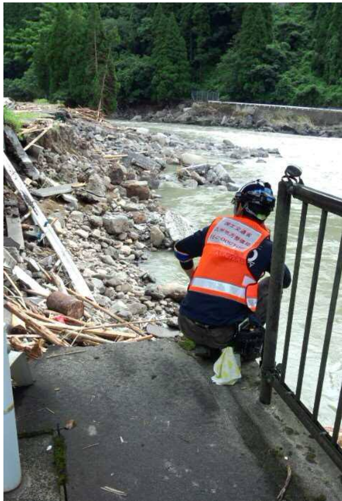
河川氾濫で護岸が流出した現場を調査
