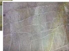
下部工のひび割れ
