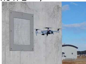
ドローンによる損傷把握
