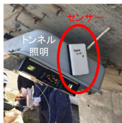
トンネル内附属物の 異常監視センサー
