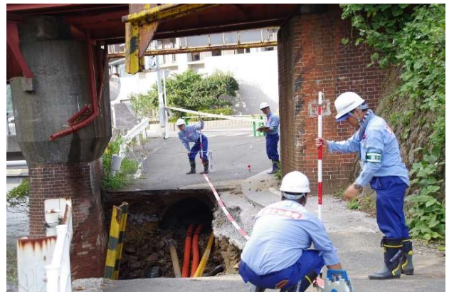
大分県津久見市大岩本線被災状況調査 (H29.9.20)
