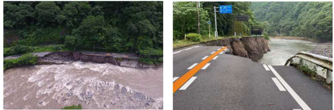
道路崩壊(天瀬町赤岩)
