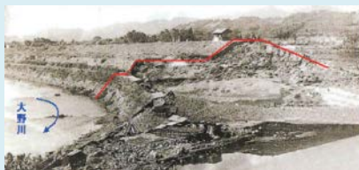
大野川8k400付近 決壊箇所
