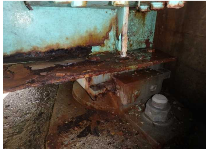
地方公共団体管理 主桁腐食
