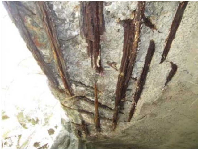
国管理 床版鉄筋露出 ※床版：橋の裏側
