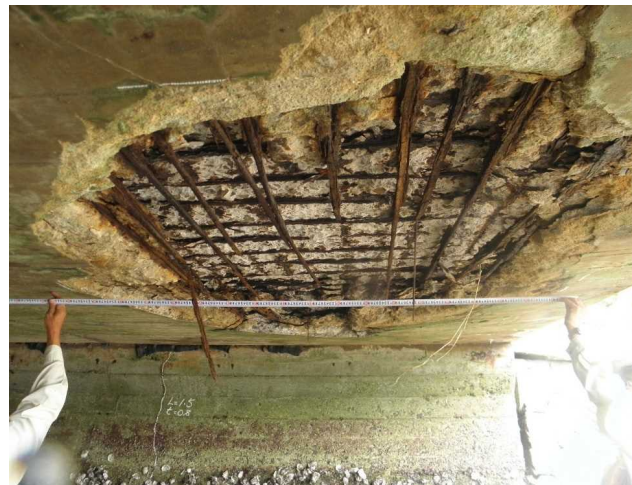
地方公共団体管理 床版鉄筋露出
