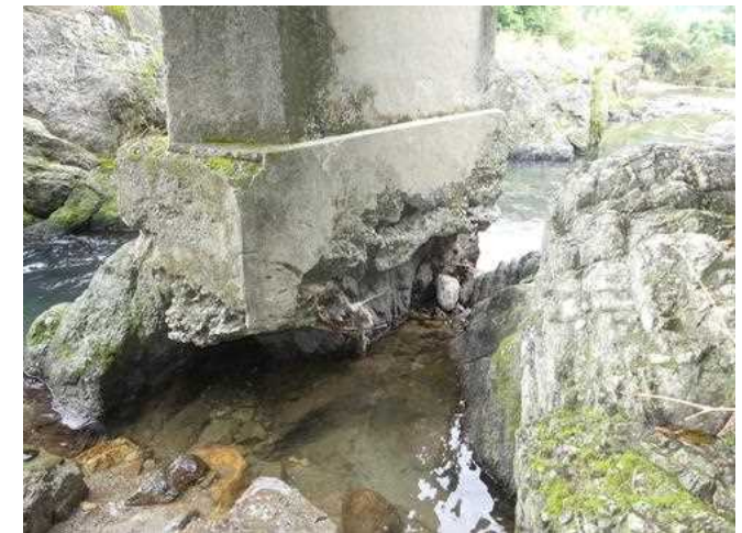
地方公共団体管理 橋脚洗掘
