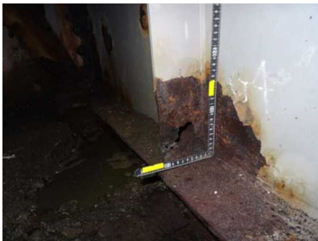
国管理 主桁腐食・欠損
