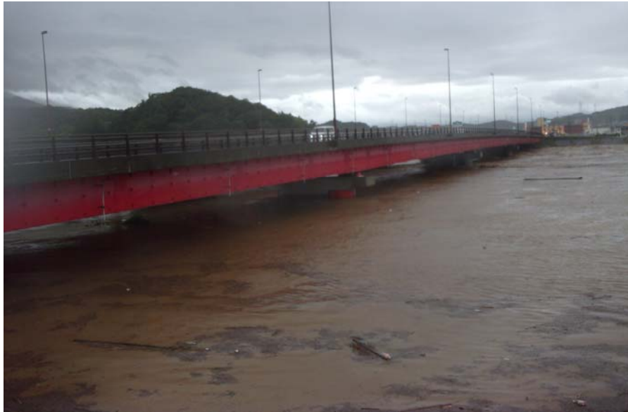
▲大野川白滝橋出水状況（H29.9.7）
