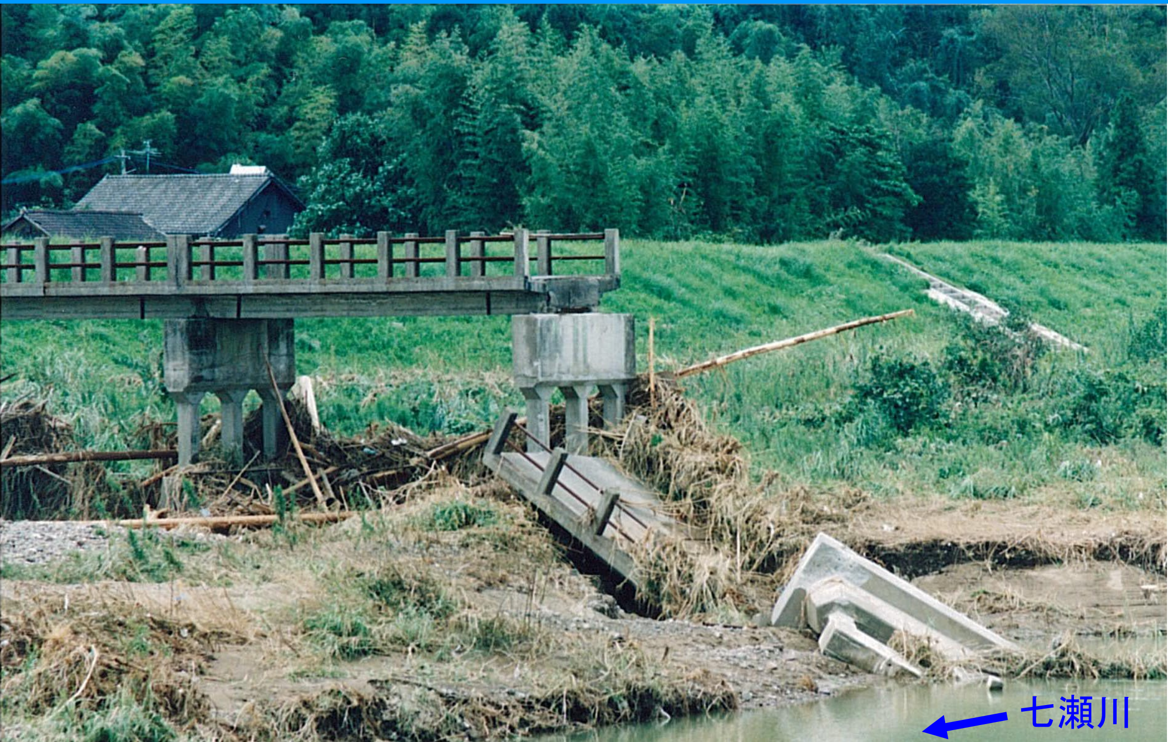
1993年(平成5年)9月洪水(台風13号) 大分川水系七瀬川 露(あらわす)橋被害状況
