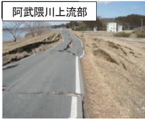
阿武隈川上流部 地震による堤防の被災状況
