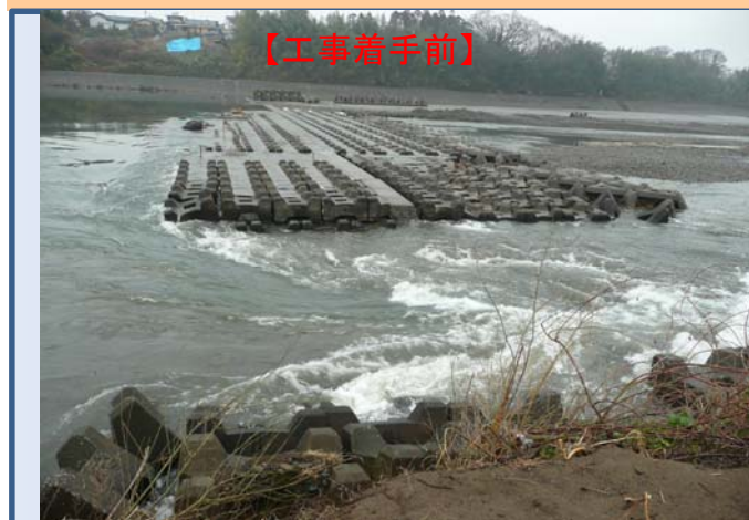
床固(手前側)の破損状況
