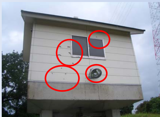
【管理施設に空けられた穴及び照明灯の破損(河川側)】
