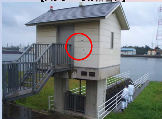
【管理施設に空けられた穴(河川裏側)】
