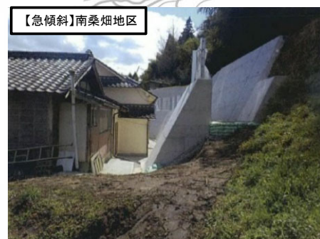
令和4年度の取組 急傾斜地崩壊防止施設の整備
