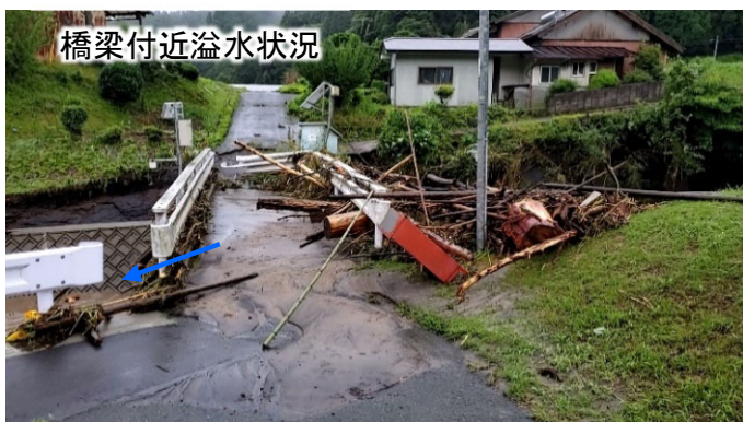
被災状況写真
