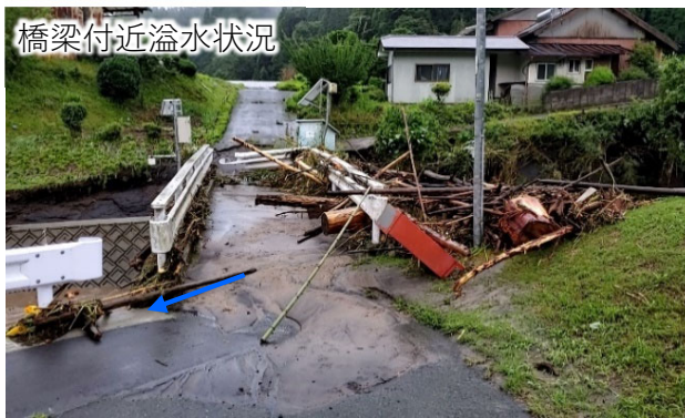
被災状況写真
