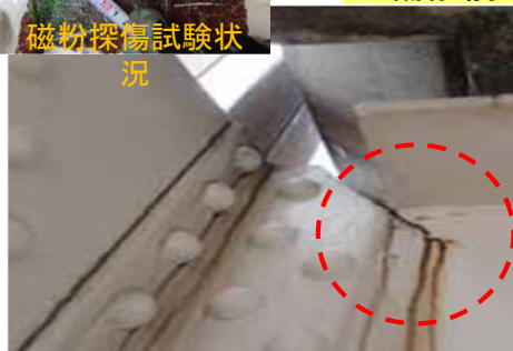
主桁(横桁)の損傷(亀裂)
