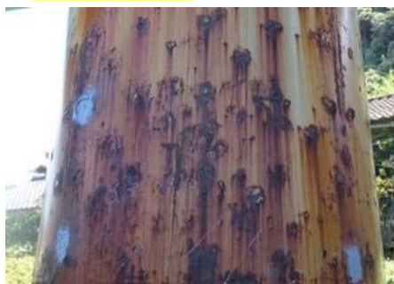
補強鋼板の腐食
