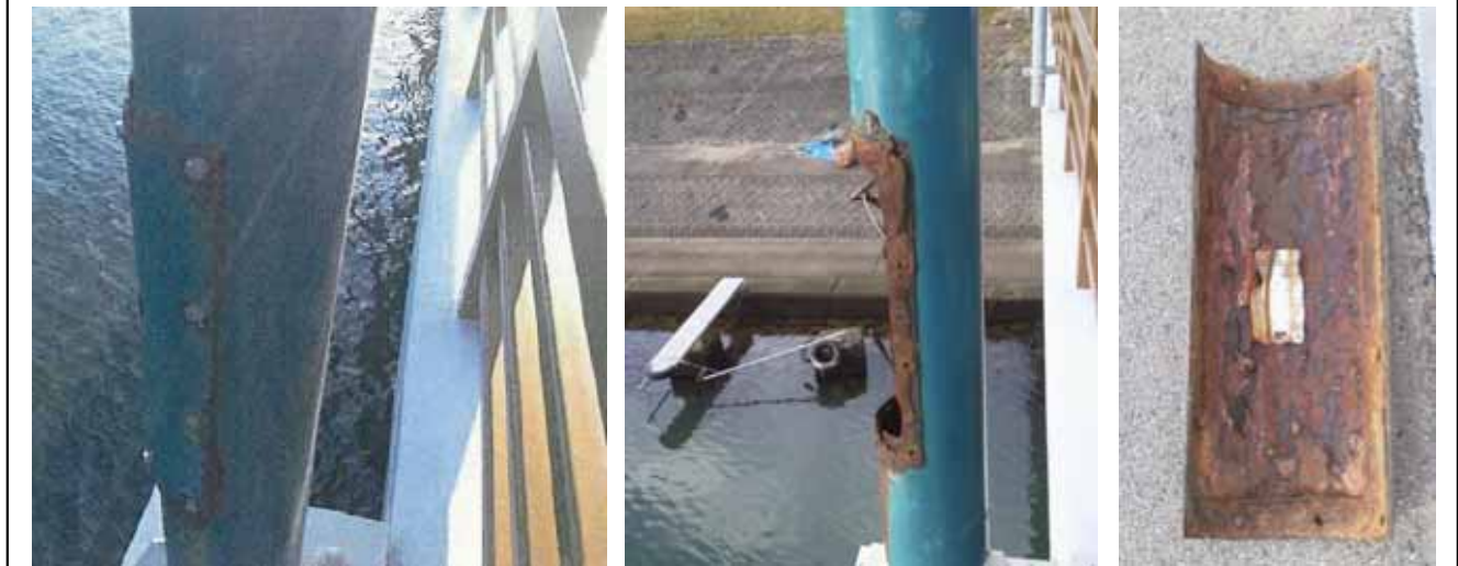
転倒した照明柱と同タイプの状況
