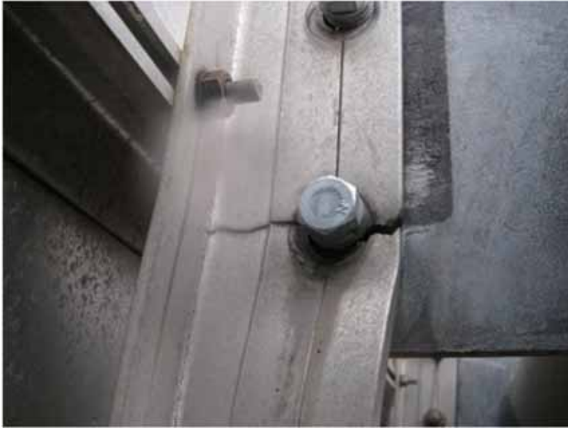
き裂損傷 (車両衝突)
