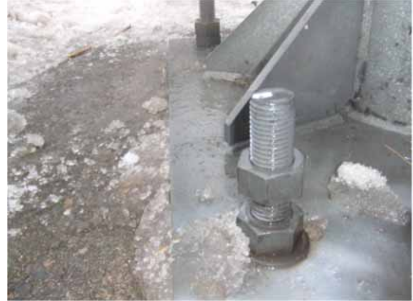
ボルトの緩み (施工不良)
