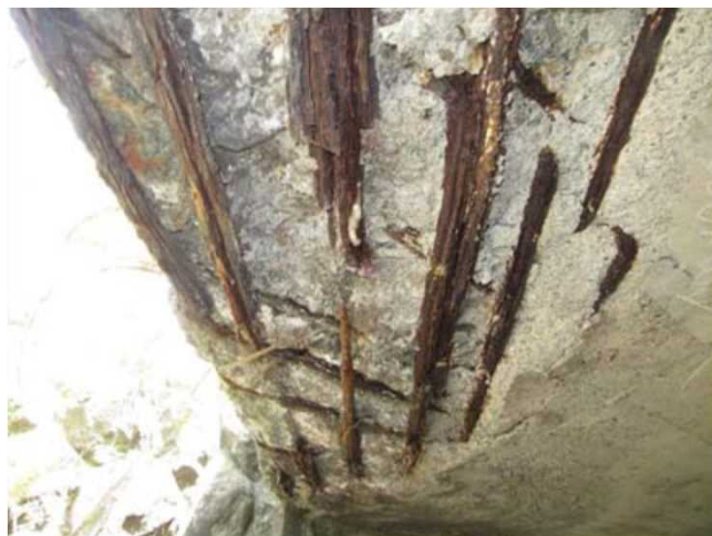
国管理 床版鉄筋露出 ※床版: 橋の裏側
