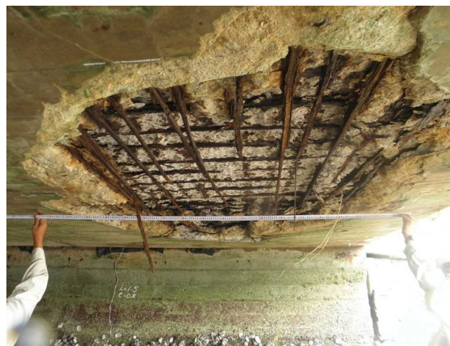
地方自治体管理 床版鉄筋露出
