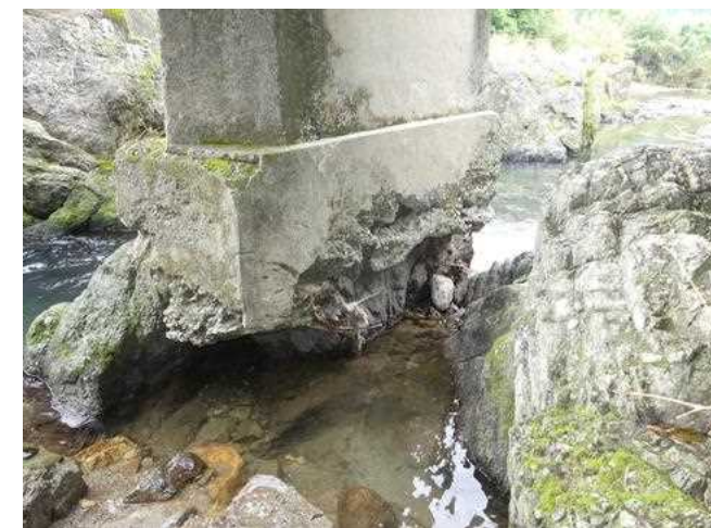
地方自治体管理 橋脚洗掘
