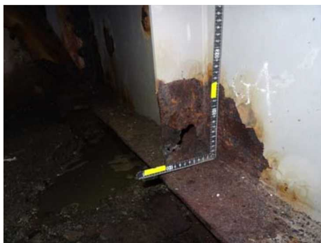
国管理 主桁腐食・欠損
