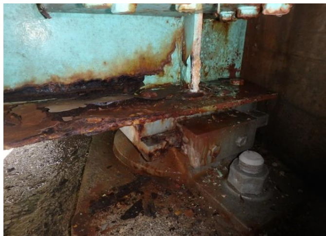
地方自治体管理 主桁腐食
