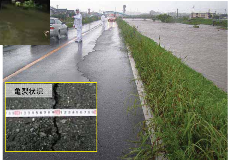
7. 26 撮影 支川中元寺川右岸3k付近 大隈地区被災状況
