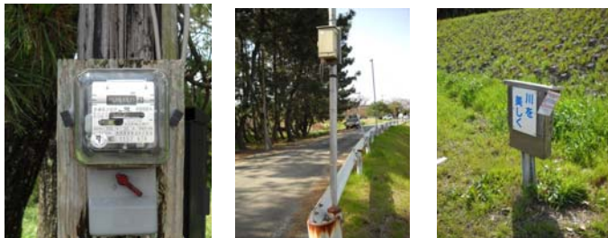
西川左岸1.0km付近 にある電源類
