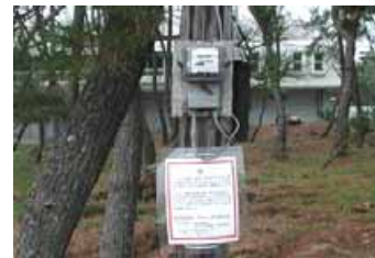
電源類に設置した一例
