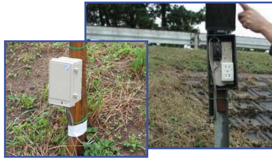
西川高水敷にある電源ソケット
