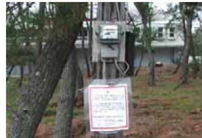
電源類に設置した一例
