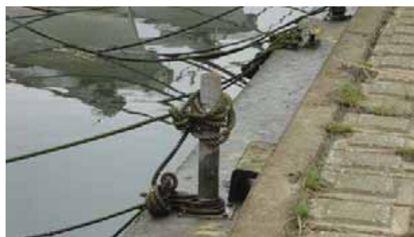
係留杭や係留環の設置による護岸の損傷
