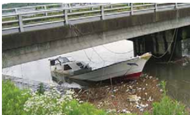
河道閉塞の恐れ(西川・道管橋)
