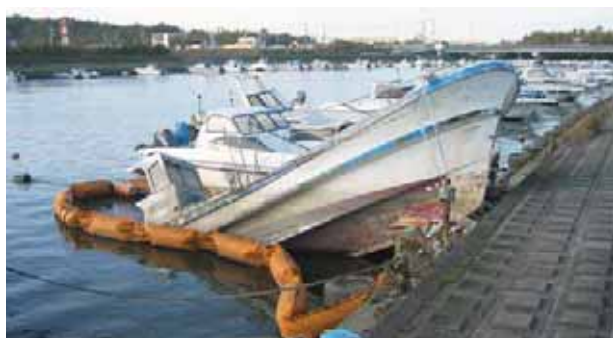
乗り上げによる護岸の損傷(西川・左岸)
