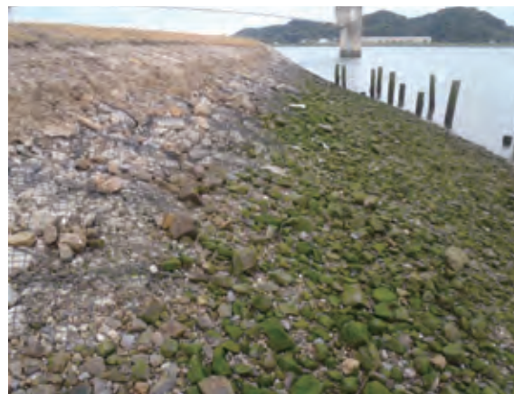
下流侵食状況
