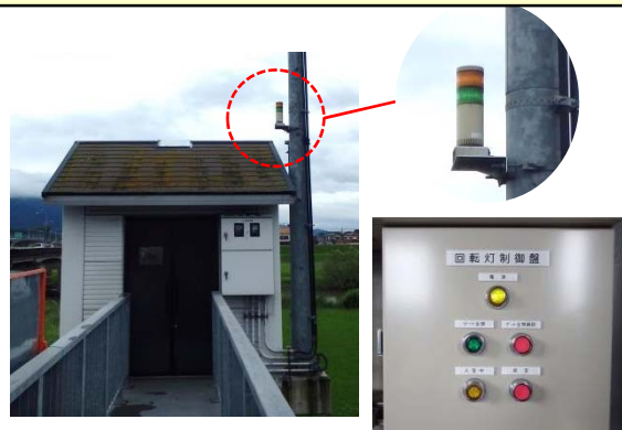
樋管上屋の回転灯（操作人出勤等の情報）
