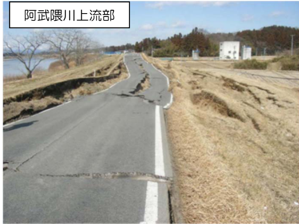
地震による堤防の被災状況
