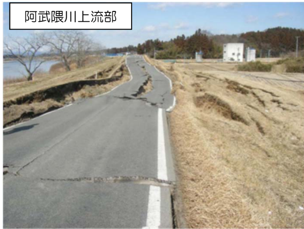
地震による堤防の被災状況
