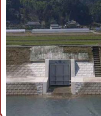
樋門樋管 (操作不要: フラップゲート)
