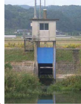
樋門樋管(操作必要)
