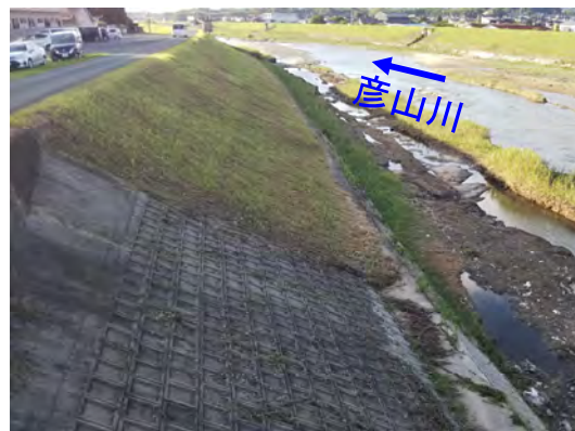
河川敷へのアクセス路が無い場合、水辺に近づけない状況（上流域）
