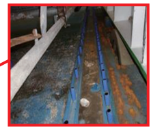
ゲート内部腐食状況
