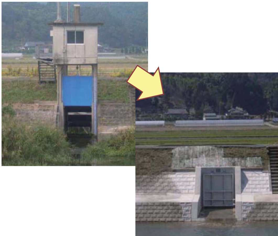
■操作員による操作を必要としないフラップゲートへの改良（無動力化）
