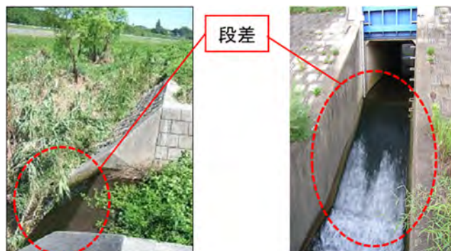
写真 2.3.20 樋門等の水路部の段差
