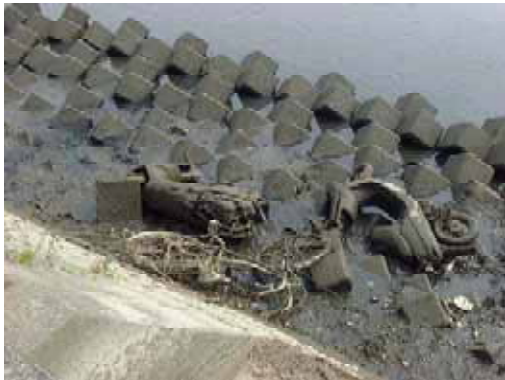
写真2.2.35 ゴミ投棄状況
