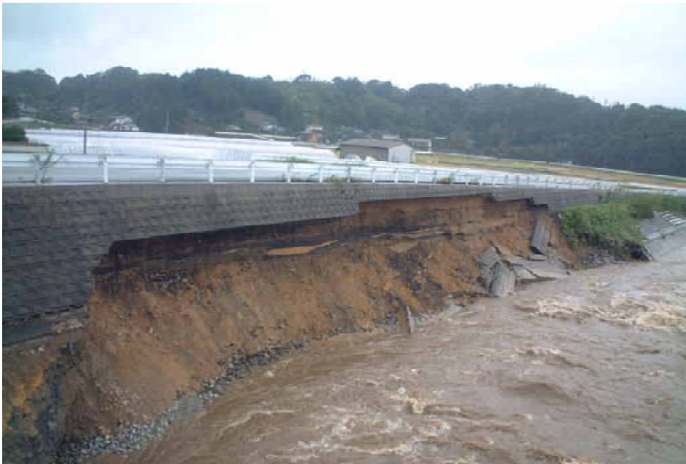
写真2.1.1 彦山川庄地区堤防被災状況（田川郡大任町 おおとう ）
