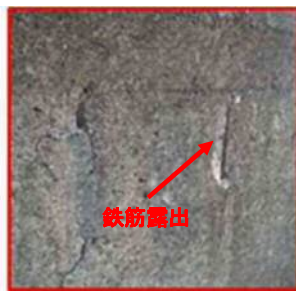
鉄筋露出状況
