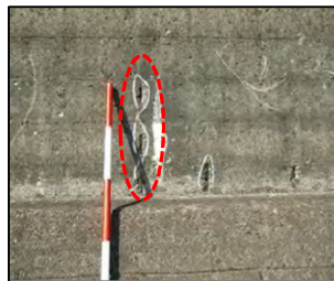
鉄筋露出状況
