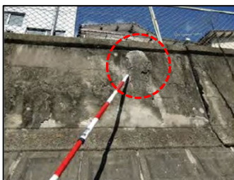
コンクリート剥離
