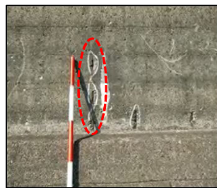
鉄筋露出状況
