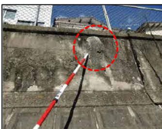
コンクリート剥離
