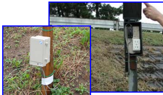
西川高水敷にある電源ソケット
