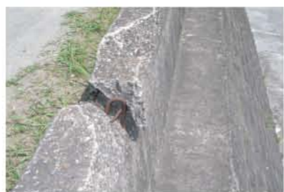
老朽化して損壊しているパラペット堤防
