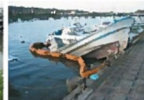
乗り上げによる護岸の損傷
