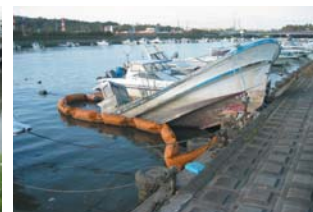
乗り上げによる護岸の損傷
