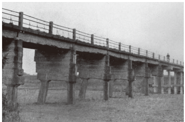
昭和40年頃鉱害沈下により幾度も継ぎ足した鴻の巣橋
