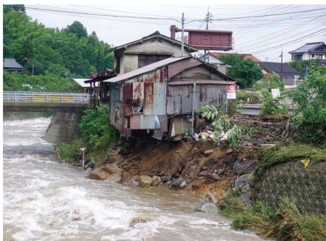
大雨で、流された護岸と家
