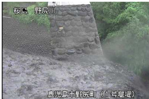
野尻川土石流の様子(6月25日)
