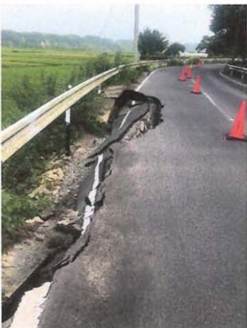
④岩弘下中線 (道路陥没)
