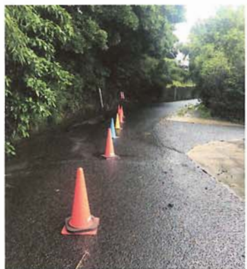
⑧早馬線 (道路陥没)
