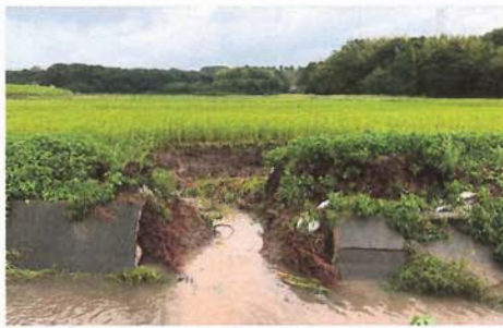
①岩弘下中線 (土砂崩れ)
