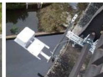
橋梁に設置するタイプ
