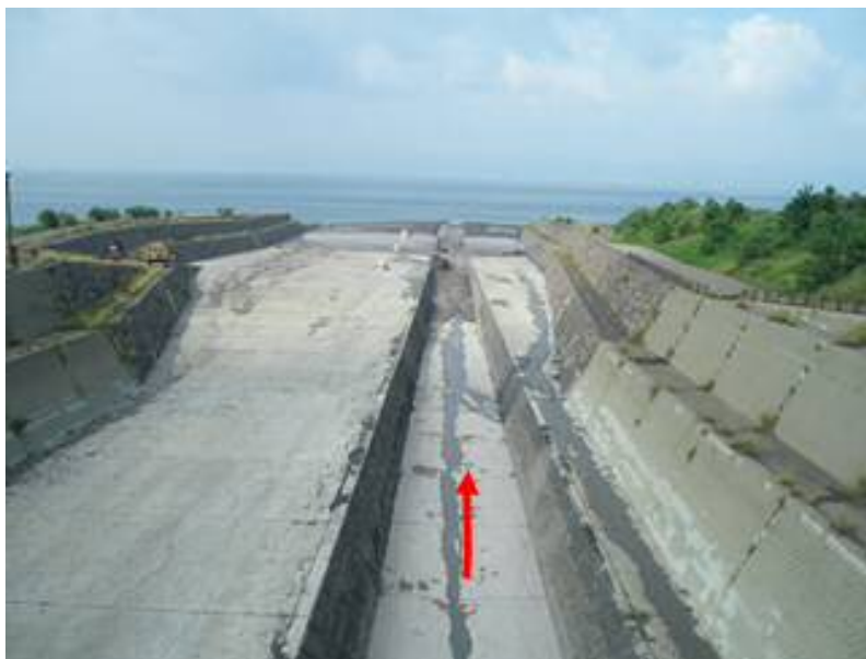
※河口付近に部分的な土砂堆積が見られる。
