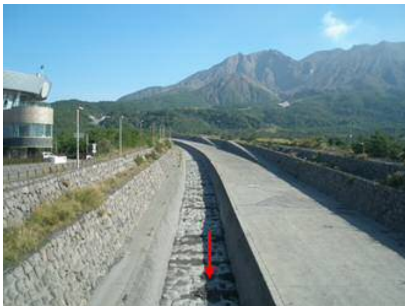
※顕著な土砂堆積は見られない。
