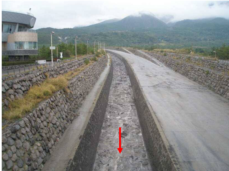
※顕著な土砂堆積は見られない。
