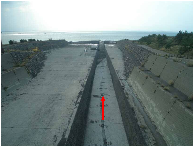
※河口付近に部分的な土砂堆積が見られる。
